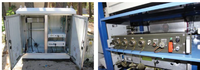
Rys. 2. Szafla połączeniowa, skrzynka podsystemu w PZR
