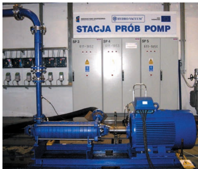
Rys. 1. Pompa WHA.3.14 na stanowisku pomiarowym (wydajność Q = 50 \text{ m}^3/\text{h} , wysokość podnoszenia: H_{14 \text{ stopni}} = 600 \text{ m} , H_{1 \text{ stopnia}} = 42 \text{ m} )
